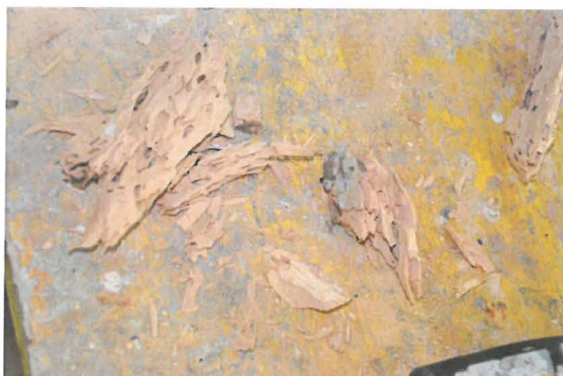
Slika 7: Les je bil zaradi poškodb na posameznih mestih lomljiv.
