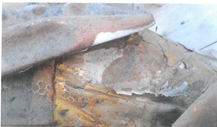
Slika 15: Odstopanje in odpadanje pozlate od lesenega nosilca.
