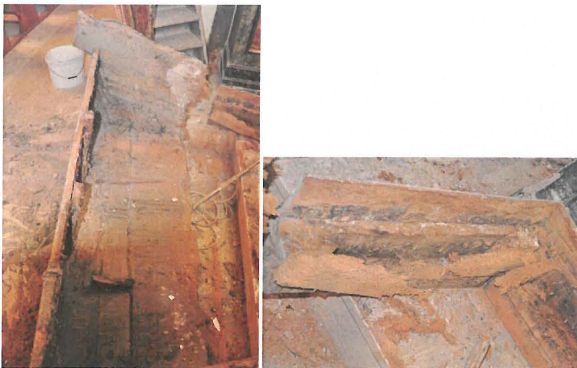
Slika 9: Pri demontaži oltarja smo ugotovili, da je bil les zaradi vlage na spodnjih delih oltarjev, povsem preperel.
